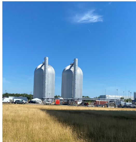
Varmeakkumulatører til fjernvarmeanlægget mod vest.
