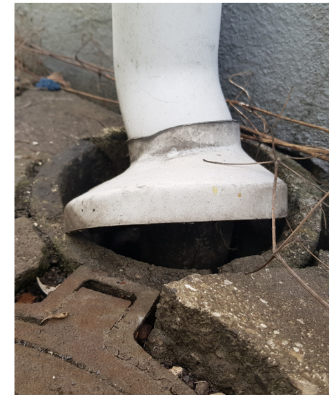
Åbent tagnedløb, hvortil rotterne har adgang.
