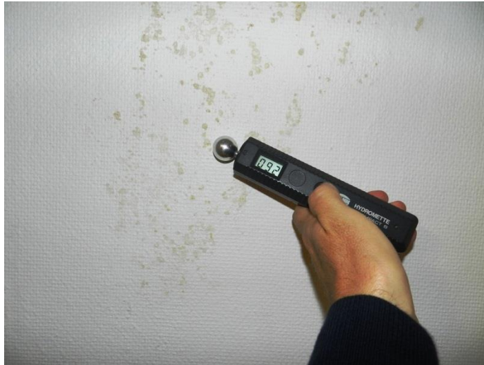
Figur 8: Opfugtning af ydervæg til en relativ værdi på 92 - meget fugtig.
