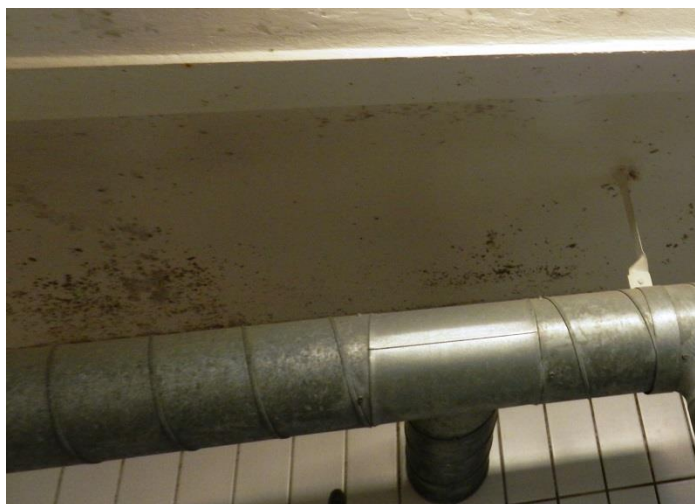
Figur 5: Synlig skimmelsvamp på loft
