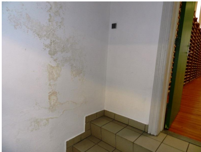
Figur 7: Opfugtning af ydervæg.
