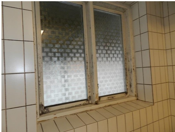
Figur 6: Synlig skimmelsvamp og nedbrydning på vindue mod gård.
