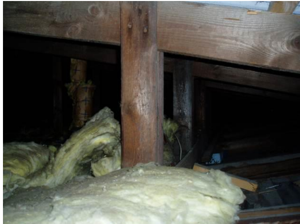
Udsnit af tagrum med aftegnning fra fugt
