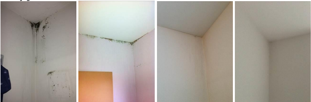
Standhavevej 82, 1. Standhavevej 92, 1. Strandhavevej 142, 1. Strandhavevej 82, 1. Fotos viser de mange skimmelvækstproblemer på loft og vægge i værelser på 1. sal.
